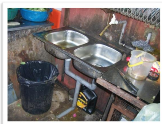
Zingki yang tidak menggunakan FOG di salah satu gerai makan
